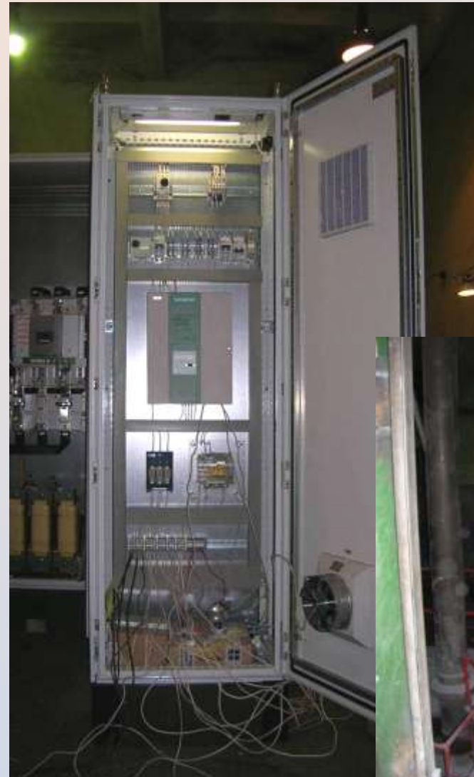
Шкаф управления механизмами
